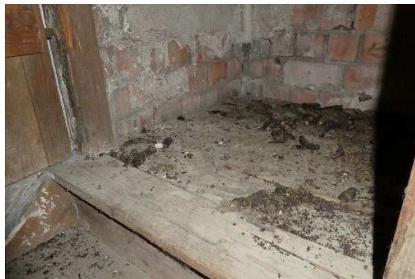
Zugang Dach, oberste Ebene. Kotspuren von Mäusen, Mardern und Waschbären. (Waschbärenvorkommen vom Eigentümer bestätigt)
